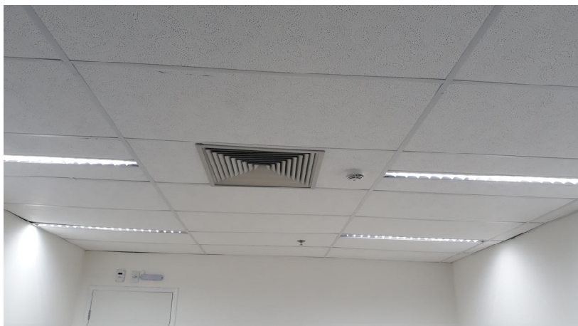
Fig. iii – Forro da sala adjacente.
