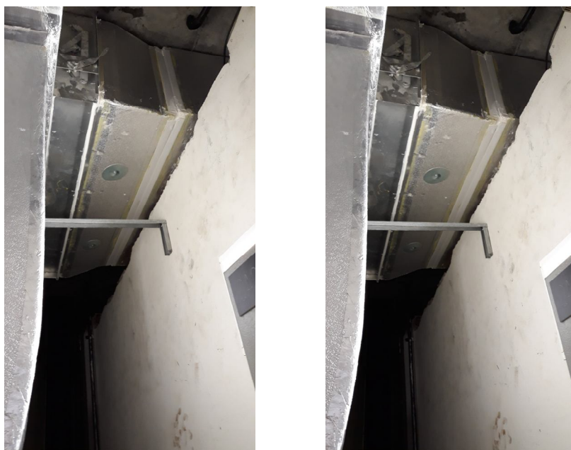
Fig. ii – Duto passando para o entreforro da sala adjacente.
